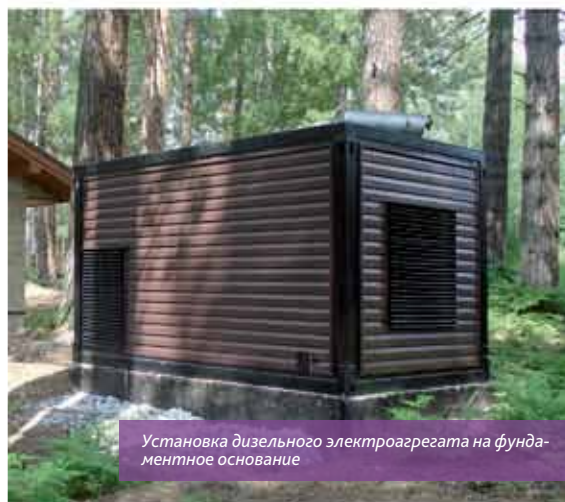
Блок-контейнер «Север» с ДГУ установлен на фундаментные блоки, промежуточный этап подключения контура заземления корпуса блок-контейнера
