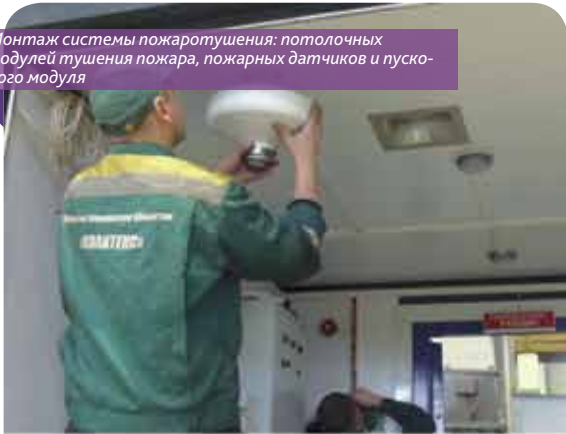
Блок ручного запуска системы пожаротушения (извещатель пожарный ручной) передает сигнал о пожаре на контрольный прибор
