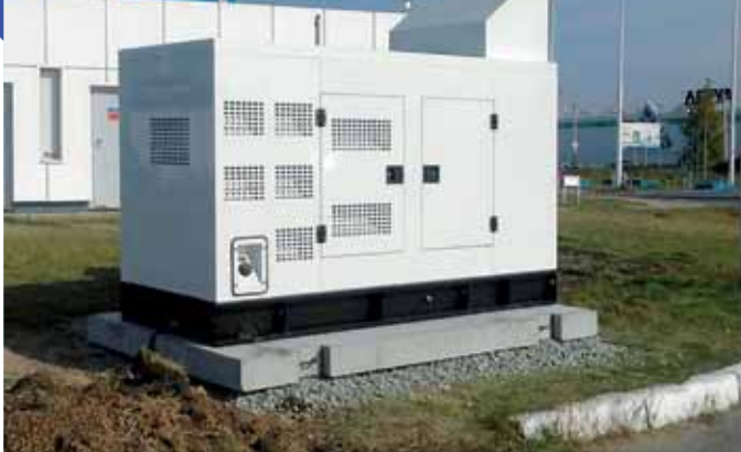
АД150-Т400-2РП г. Омск автозаправочная станция №40
